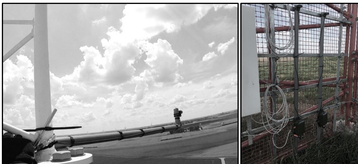
Figure 1 – Enregistreurs automatiques équipant le mat de mesures du Moulin d'Emanville, SM4BAT FS avec micro SMM-U2 à différentes hauteurs (source : ING Environnement)
